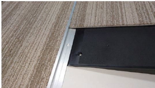
スロープ（施工例）
